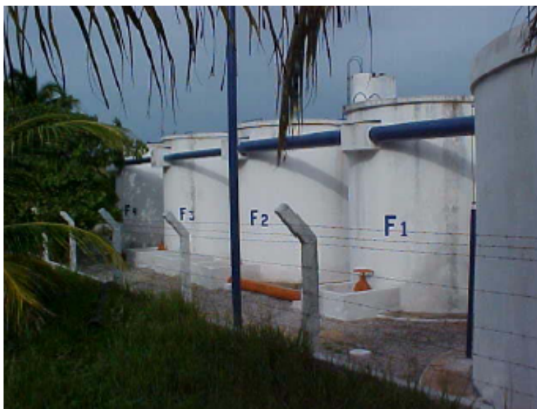
Figura 26 – Filtros no local de captação de água bruta, em Paracuru
