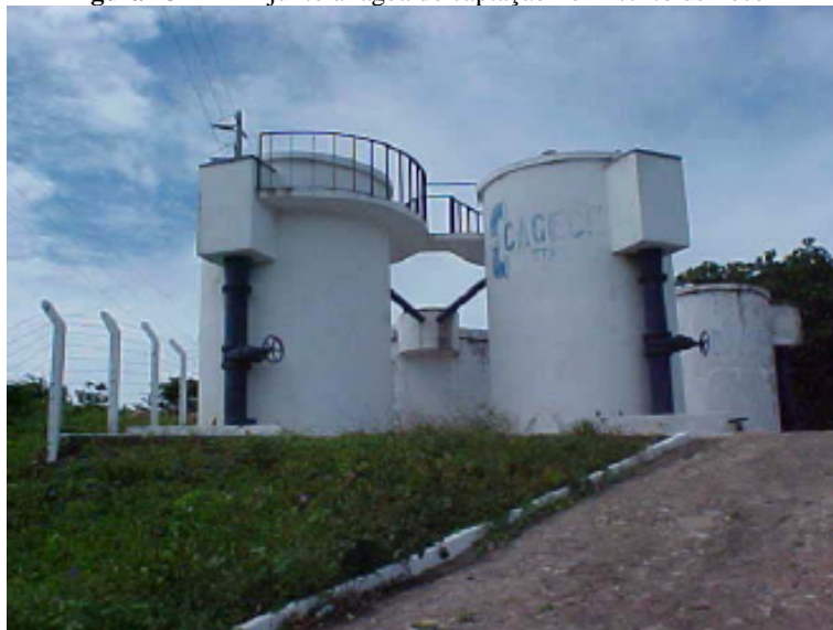
Figura 23 – ETA junto à lagoa de captação no Distrito de Pecém
